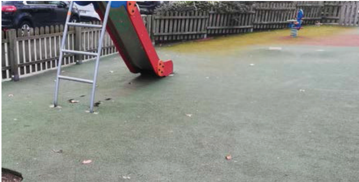
Zona de joc infantil amb manteniment deficitari.
