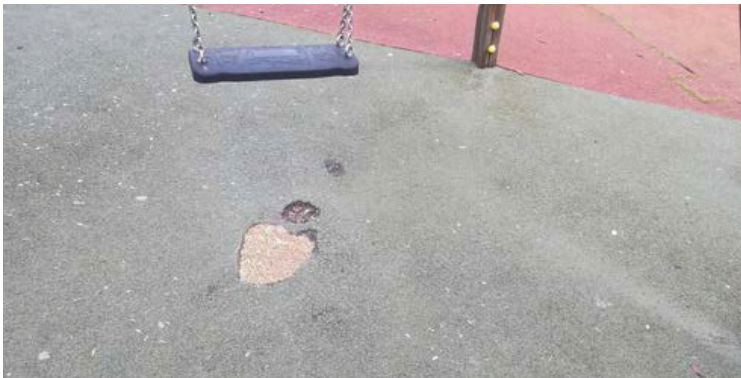
Superfície de cautxú deteriorada, cosa que genera perill de caigudes dels infants.
